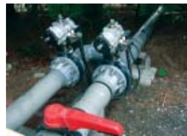
紧急时使用的配管
