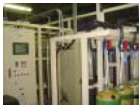
排水回收装置
