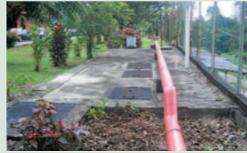
处理罐的上部
